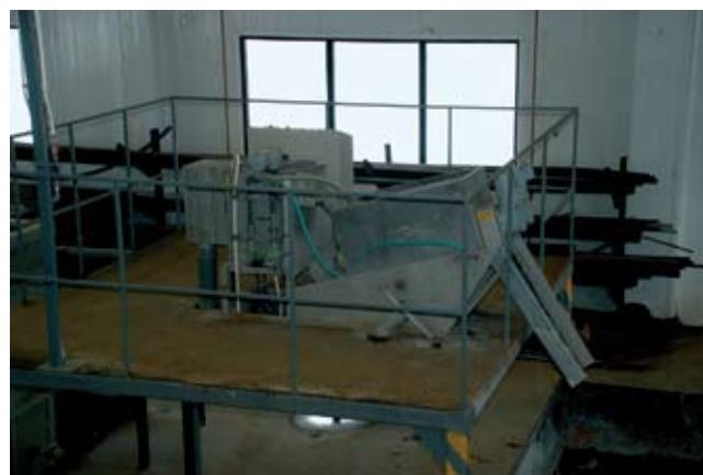
Рис. 3. Шнековый дегидратор обезвоживания отходов очистки
